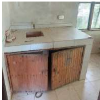
Fotografía 2. Estado actual del mobiliario interno del Punto de Información
