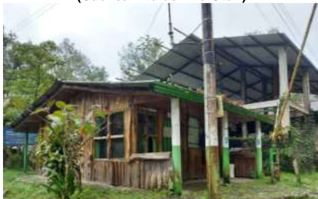
Fotografía 1. Punto de información de Aguas y Aguas de Pereira en condiciones de abandono (Cuenca Alta del Río Otún)
